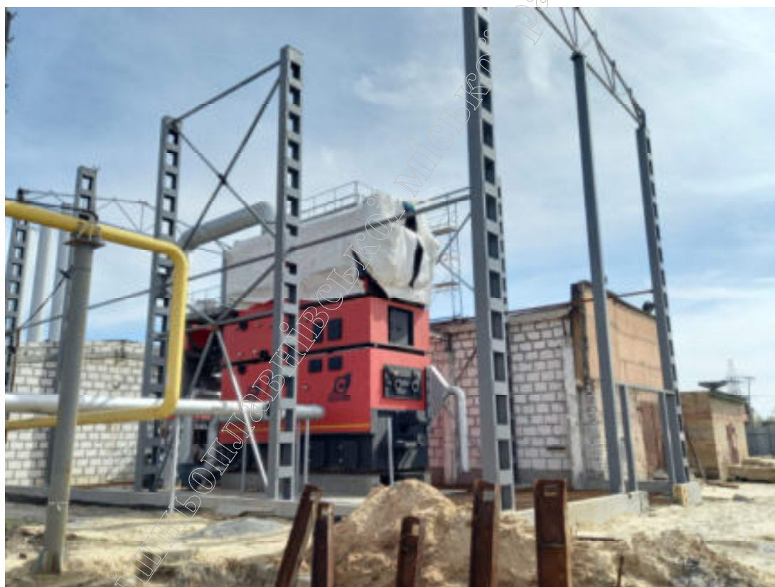
Сталевий водогрійний котел на біопаливі типу «COMPE-R» потужністю 7 МВт
